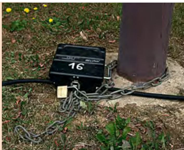
Photo 11 : compteur fixé avec une chaîne.
